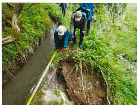
水路からの吸出しによる被災
