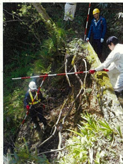
用水管理用通路の欠損 （大桑ゲート 付近）
