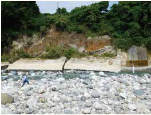
▲7月6日 常願寺川右岸護岸擁壁倒壊
