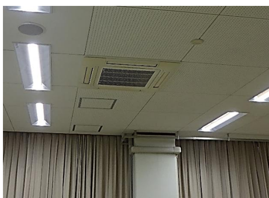
空調設備が設置された教室
