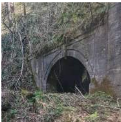
写真 15 本宮～立山駅間に現存する隧道跡 (筆者所蔵) 現在の線路の川側にある。芳見橋近くに現存している隧道の坑門と同じ模様が見られる。本宮方の坑門は原形をとどめているが、立山方の坑口は崩壊している。
