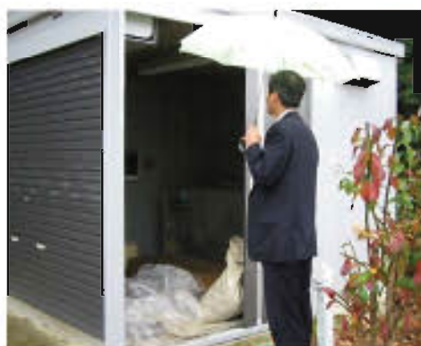
グリーンパーク吉峰に生ゴミ処理機が設置されている
