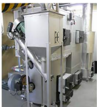
あおぞら保育園のペレットボイラー
