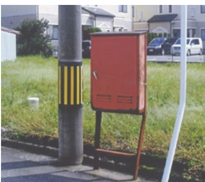
4km圏内にある消火栓器具
