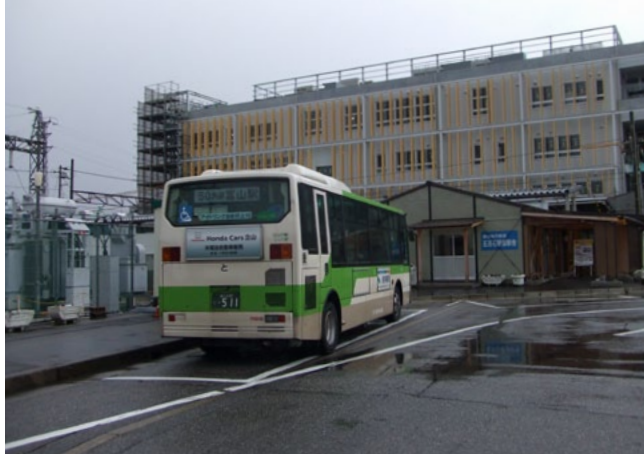
▲五百石駅西かぼちやから見流た、建設中の元気交流ステーション
