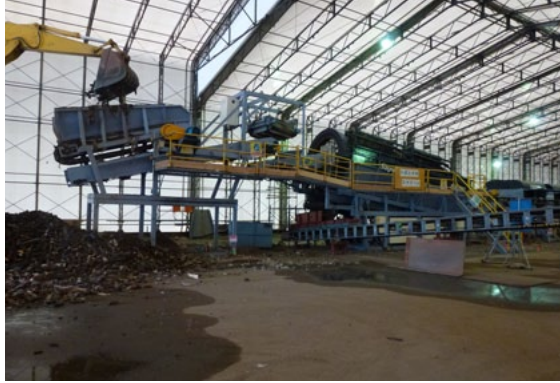
がれき破碎選別施設
