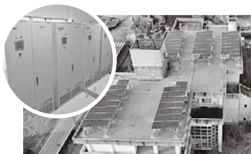
釜ヶ淵小のソーラーパネル&蓄電池
