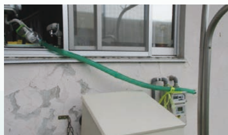
エコキュート設置前
