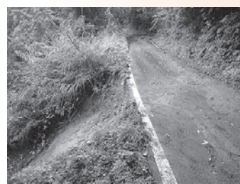
路肩が流出した林道目桑線
