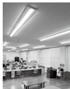
↑ 庁舎1階のLED照明
