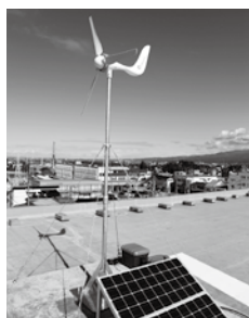
↑ 庁舎屋上の小型風力発電機
