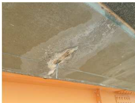
床版の漏水(雷鳥大橋)
