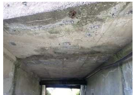
床版の鉄筋露出(無名橋174)
