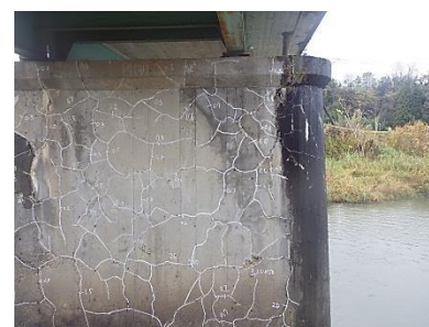
橋台のひびわれ (供用 51 年)
