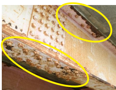
鋼桁の塗装はがれ・腐食 (供用 45 年)
