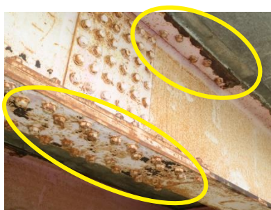
鋼桁の塗装はがれ・腐食 (供用 45 年)
