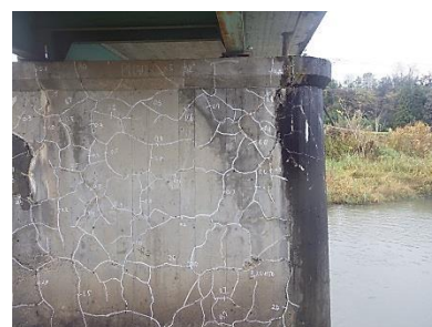
橋台のひびわれ (供用 51 年)
